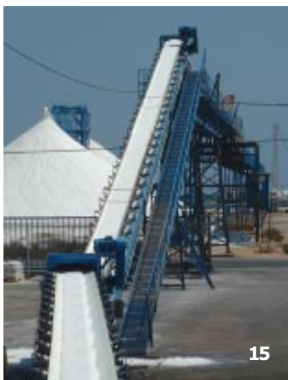
15. Segundo transportador (inclinado).
